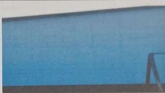
Foto 8: Pintura en muros exteriores de todos los módulos del establecimiento
