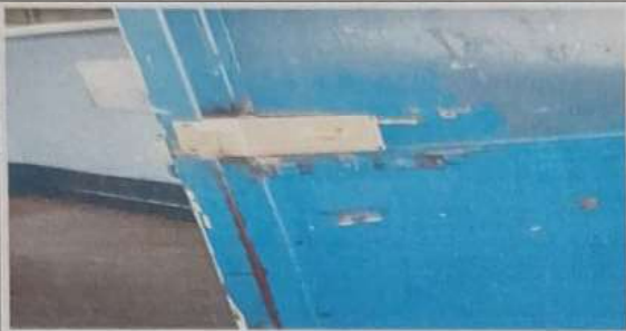
Foto 7: Sustrucción de chapas marca yale, aulas ubicadas en los módulos 1,2,3 del establecimiento.
